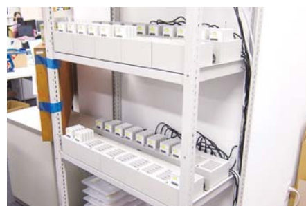
事務部門に設置の充電ラック
