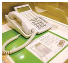
多機能電話機で 呼出カードへ
